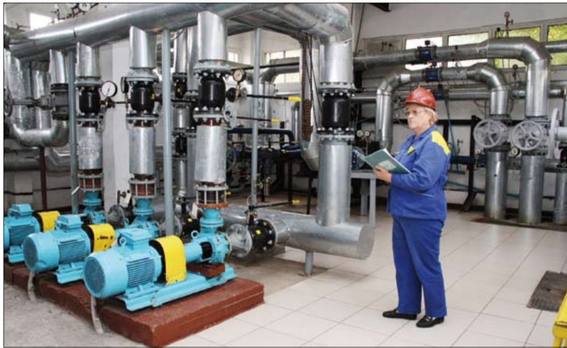
В новом теплопункте чисто, светло, да и работать здесь стало куда легче.
